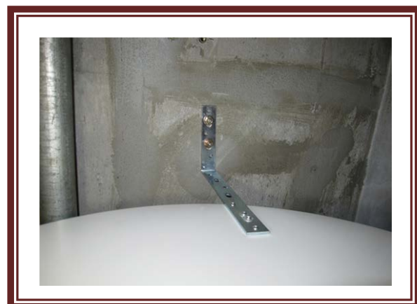
ローズハイツの一室 L字鋼材でタンクの 天板を壁面に固定
