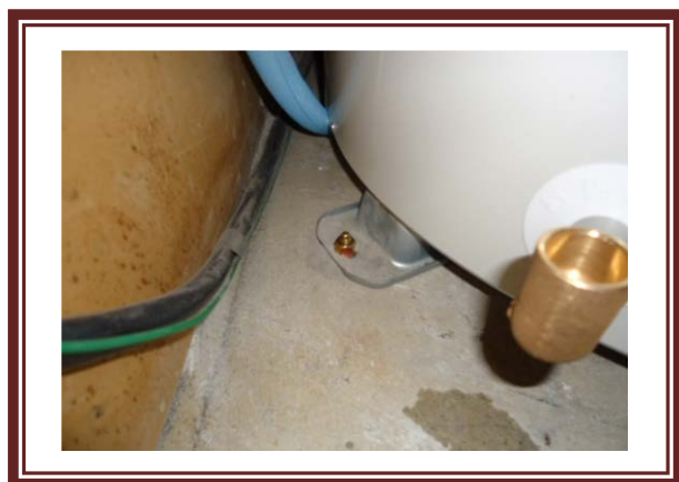
ローズハイツの一室 アンカーボルトでしっかり固定 されています。
